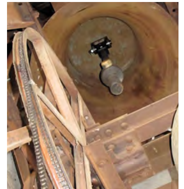
Das hölzerne Antriebswerk der Friedenskirche. Durch den Einbau der elektrischen Steuerung ist das große Antriebsrad mit dem Pendel nicht mehr erforderlich
